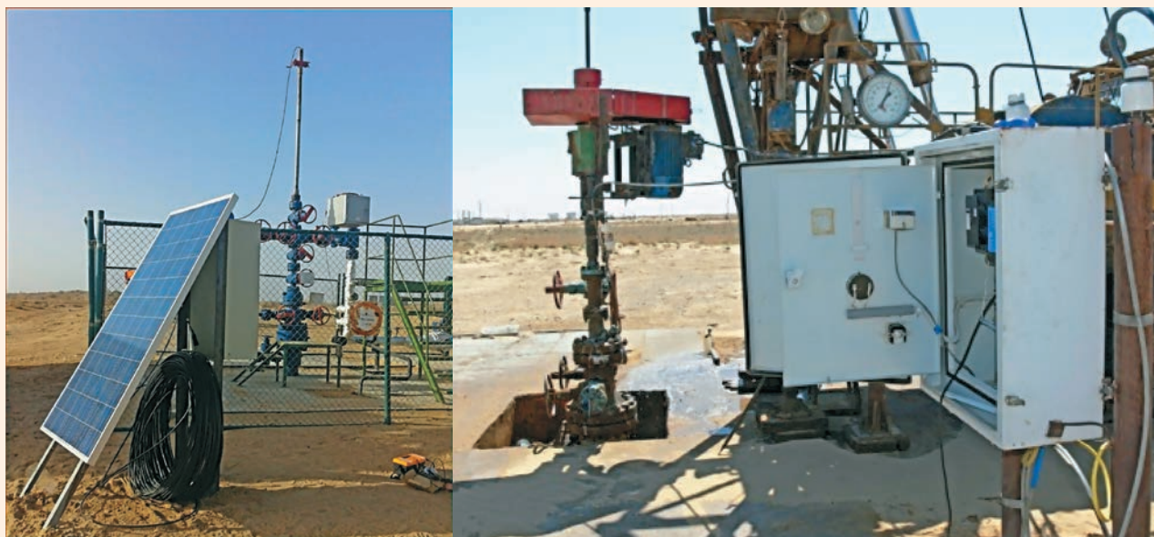
Рис. 3. Оборудование системы дистанционного мониторинга
